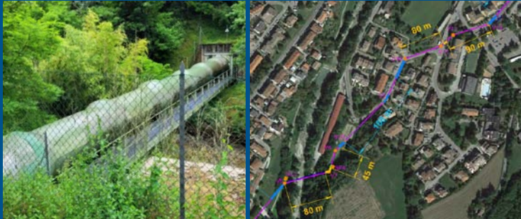
Condotta Principale auf einer Rohrbrücke (links), Planung von Einbauabschnitten in der Ortschaft Santa Sofia (rechts)
